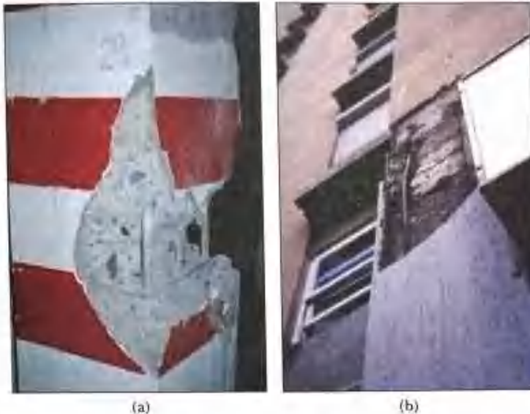
Figura 2.3. (a) Aspecto de pilar de sótano fracturado en la zona lateral intermedia. (b) Aspecto de pilar de fachada fracturado. Tanto la figura a como la b son daños patológicos como consecuencia de un movimiento sísmico en Canarias.
