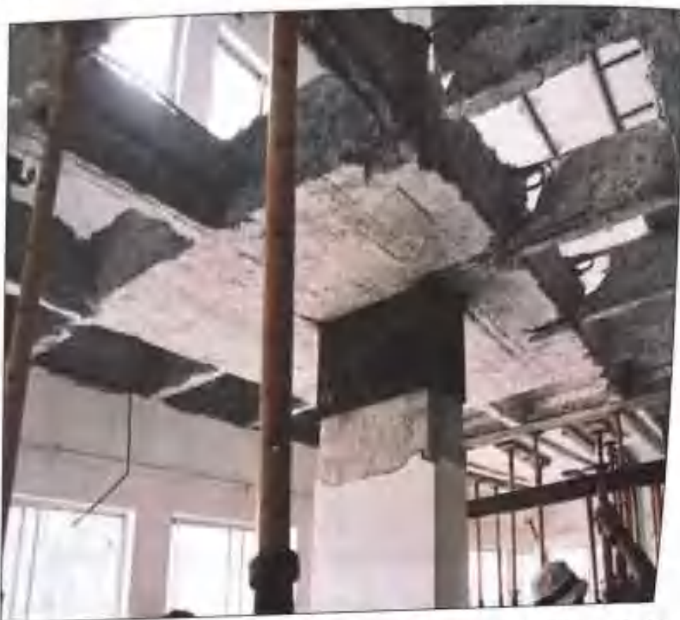
Figura 2.2. Aspecto de forjado reticular fracturado y pérdida de casetón de bloque por acciones horizontales extremas.
