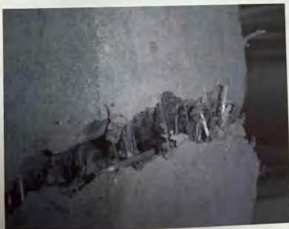
Figura 3.30. Imagen de la fisura una vez finalizado el ensayo de carga estática de flexión a 3 puntos de una probeta prismática de 40 x 10 x 10 cm de FRC 0,8% PP. 40 mm.
